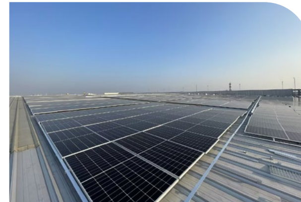
杭州公路港屋顶光伏
